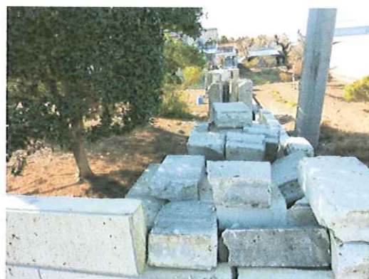
神社に隣接する敷地の 大谷石塀 (東側)
