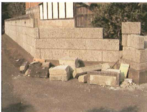
No. M-6 (真岡市下籠谷) 鉄筋入り大谷石塀 (無被害)
